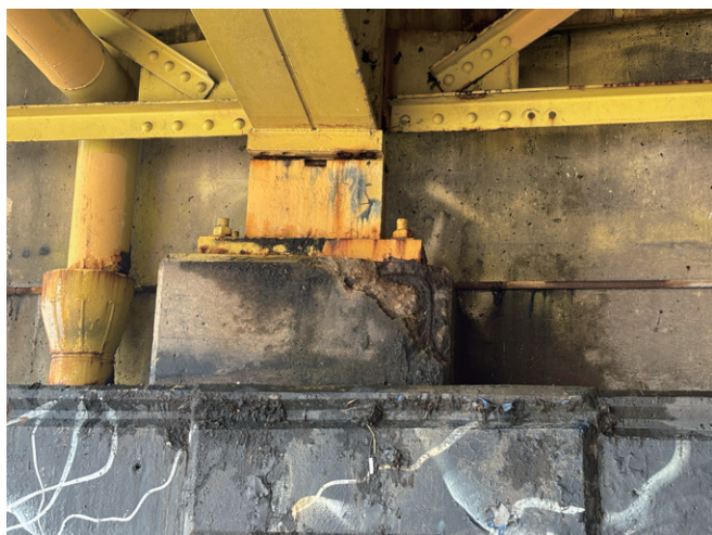
写真－14 支承部の損傷状況（腐食、鉄筋露出）
