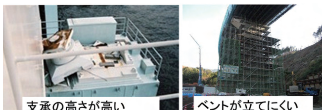
図-5-3 復旧困難事例 (左: 支承の高さが高い、右: 資機材配置が困難)
