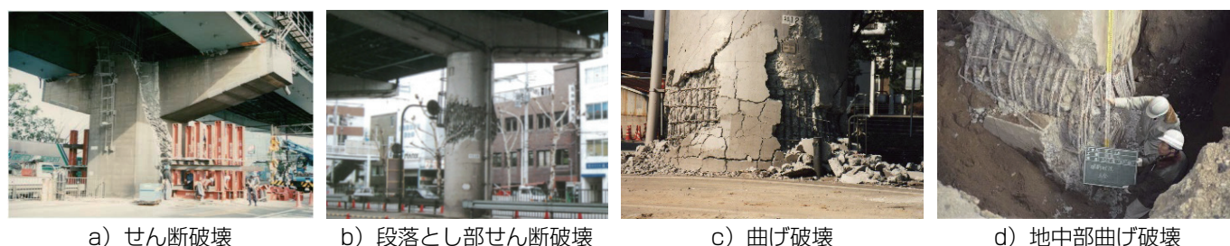
写真4 RC橋脚の代表的損傷
