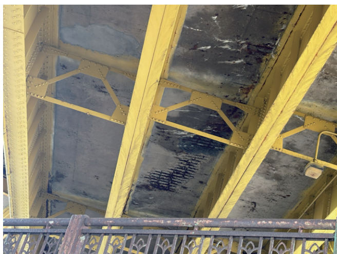
写真－13 床版の損傷状況（鉄筋露出、漏水・遊離石灰）
