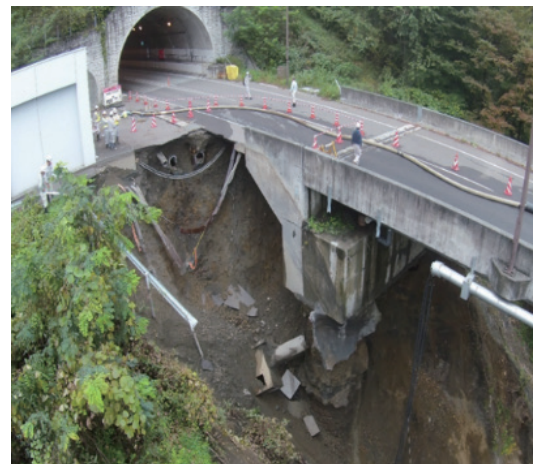
図-5-8 トンネル坑口と橋梁として設計する区間の取り合いにおける水処理に起因する崩落事例
