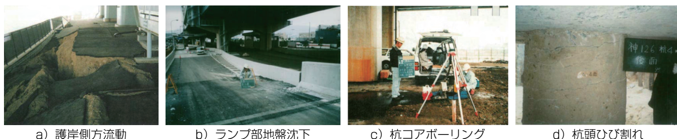
写真-6 基礎の代表的損傷
